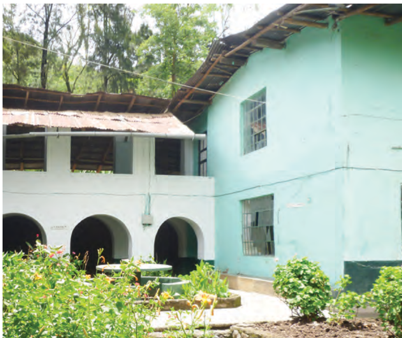
Rechts auffälliger Bauteil des Hospitals: Dach und Wände müssen repariert werden
